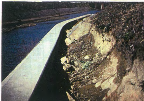
のり肩侵食例
